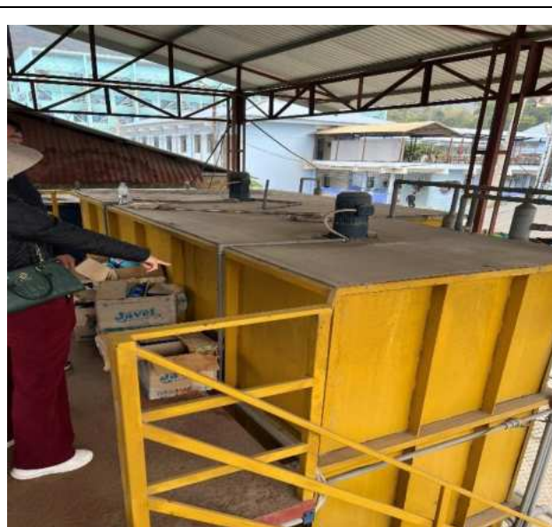
Cụm bể yếm khí
